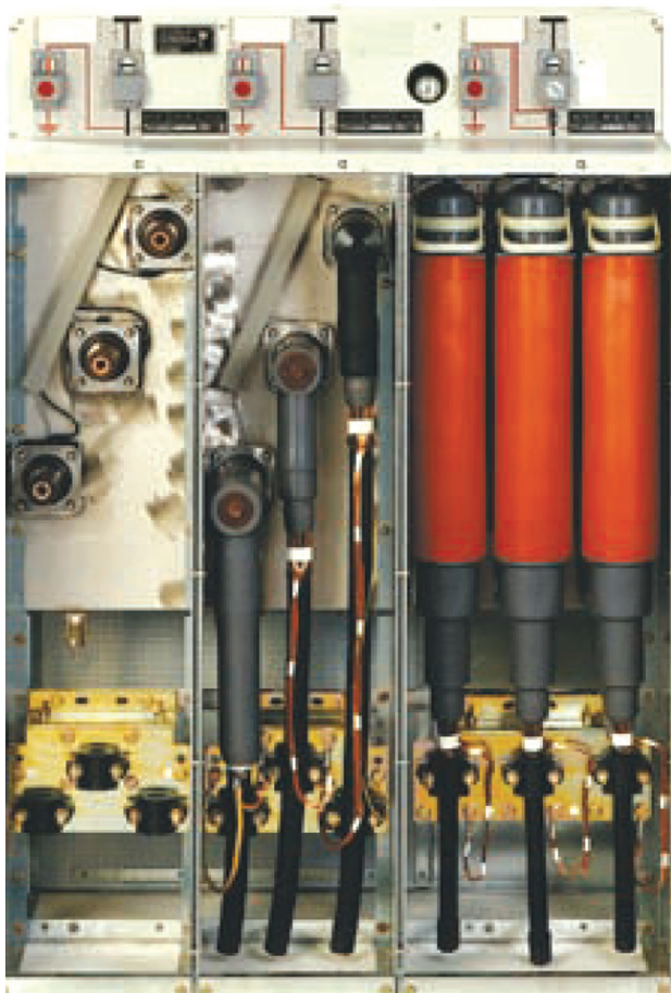
Отсек подключения силовых кабелей
