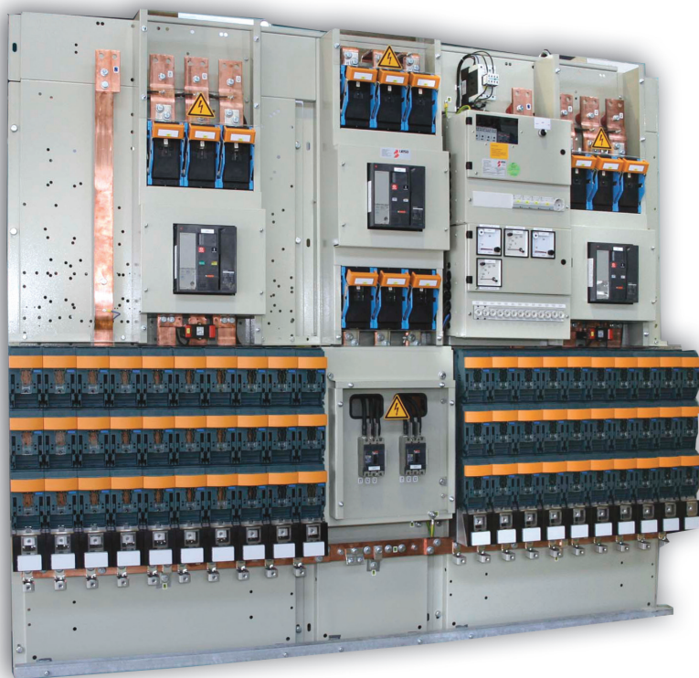
НКУ БЭМ на монтажных панелях
